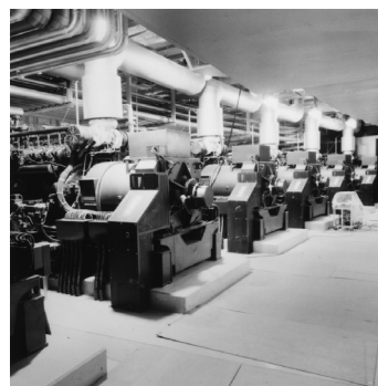
コージェネレーションシステム
