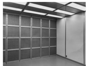
高砂層流式クリーンルーム
