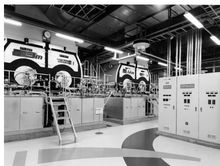
汐留北地区地域冷暖房施設ボイラー室
