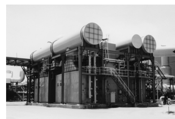
高炉除湿装置
