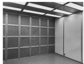
高砂層流式クリーンルーム
