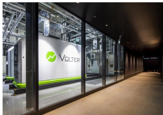
木質バイオマスガス化発電機
