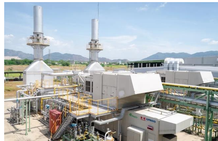
ベトナム/ガスタービン (天然ガス燃料) コジェネレーションシステム
