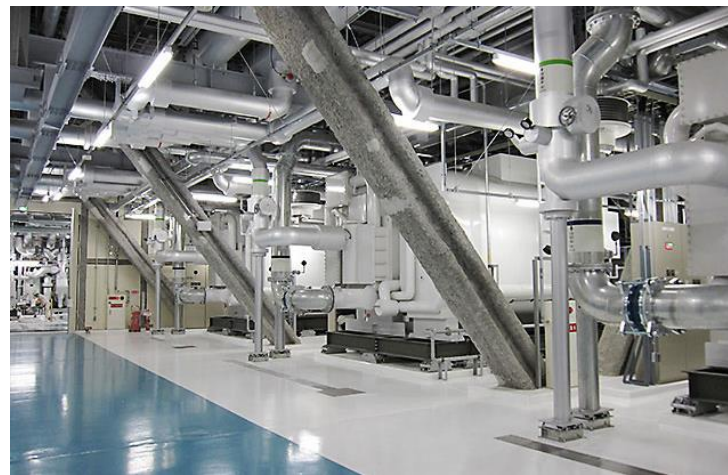
大阪エネルギーサービス株式会社 第2プラント
