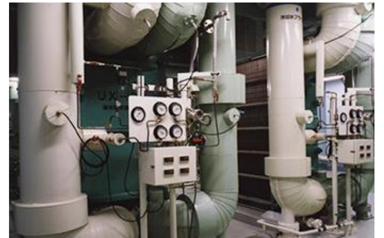
四国電力株式会社（サンポート高松地区熱供給センター）
