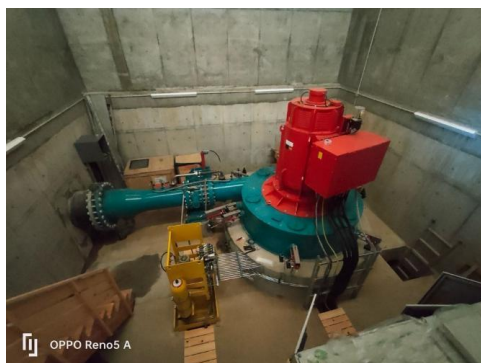
小水力発電設備 写真は阿多野郷川発電所（高山市）
