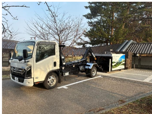
熱を運搬するトラックと、プール施設外に新設した熱を受け入れる設備
