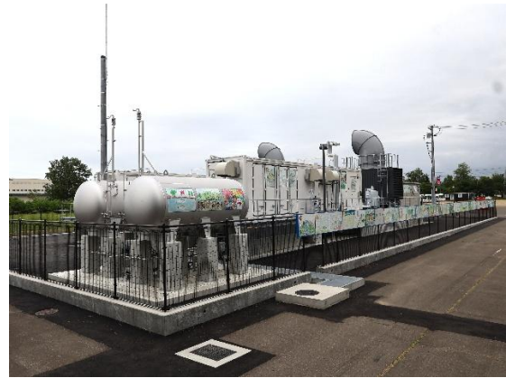
水素製造設備 外観
