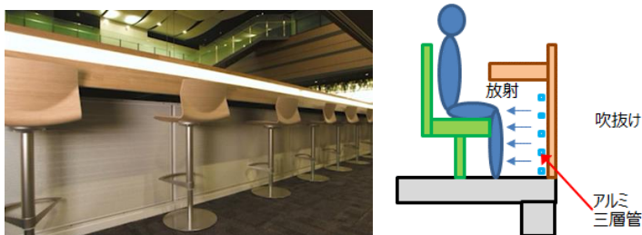
図 15 カウンター空調の外観とイメージ
