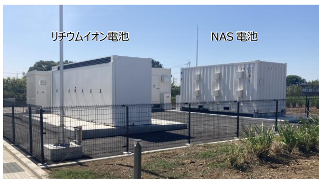
写真1 蓄電池設置状況
