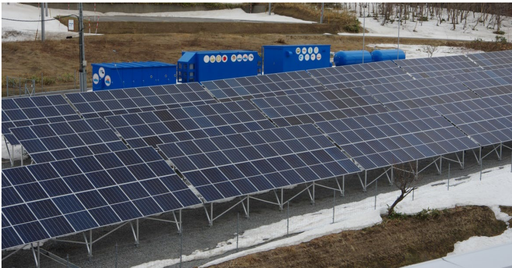
写真 2 太陽光発電設備
