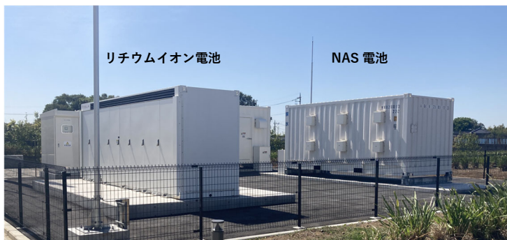
写真1 蓄電池設置状況
