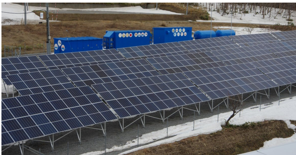
写真 2 太陽光発電設備
