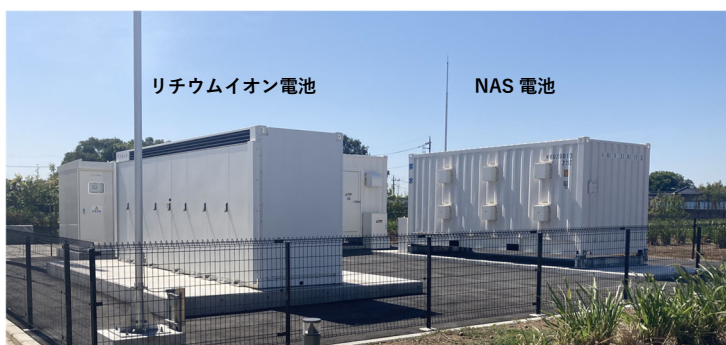
写真1 蓄電池設置状況
