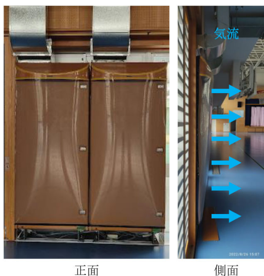
図2 ビニール風船型吹出し口の設置状況
