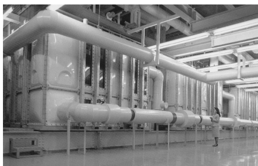
図 44 幕張地域冷暖房施設での実証試験設備 54)
