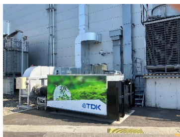
(c) 放熱サイトの外観
