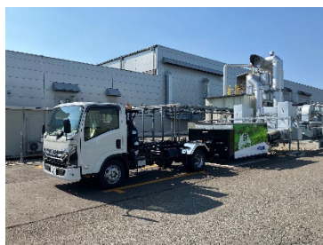
(b) 蓄熱サイトの外観
