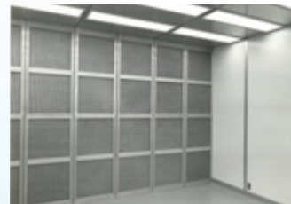
高砂層流式クリーンルーム
