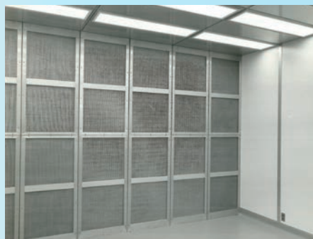
高砂層流式クリーンルーム
