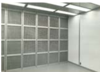
高砂層流式 クリーンルーム
