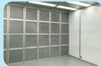
高砂層流式クリーンルーム
