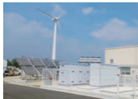
独立行政法人産業技術総合研究所の福島再生可能エネルギー研究所における太陽熱蒸気供給システム(左手奥)と水素利用型蓄電装置(中央から右手前のユニット)
