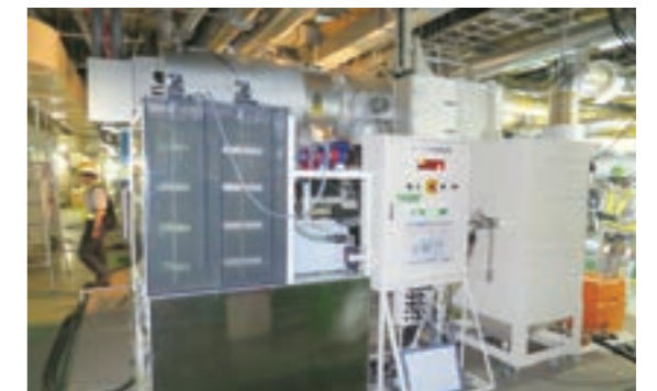
現場設置状況
