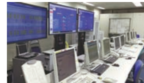
JR東日本東京駅 設備監視センター
