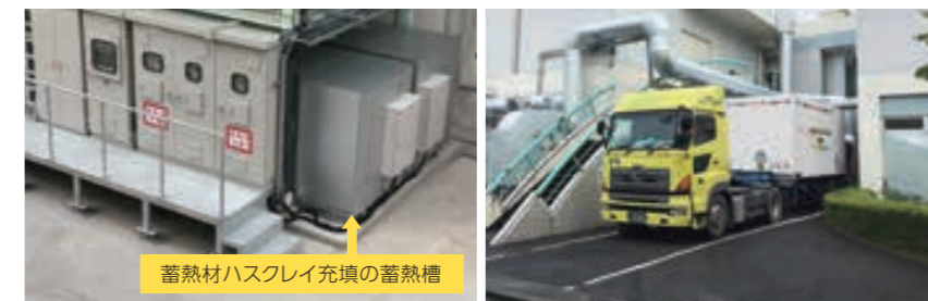
定置型蓄熱システム外観
