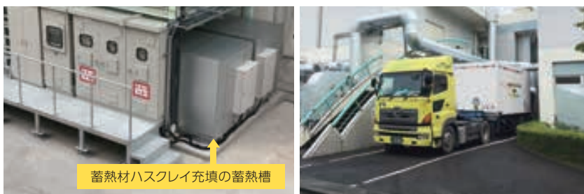
定置型蓄熱システム外観
