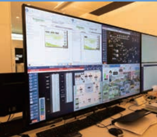
執務室の快適性をモニタリング
