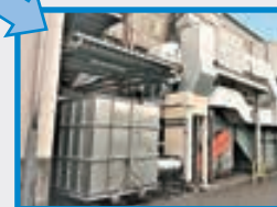
工場内産業空調(塗装工程) →除湿・加熱負荷削減
