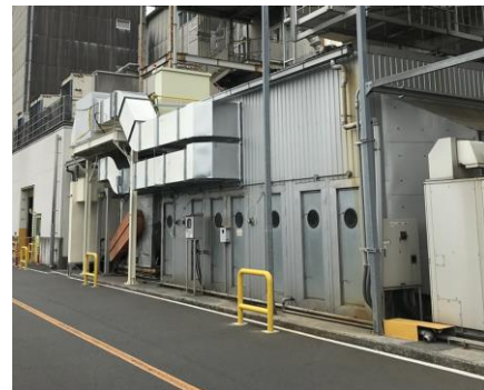
図4 熱利用サイト(放熱サイト)外観 (日野自動車(株)羽村工場内の産業空調設備)
