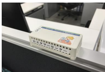
図1 無線温度センサー設置状況
