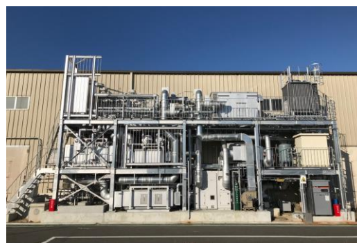
図2 寺岡製作所での本システム外観
