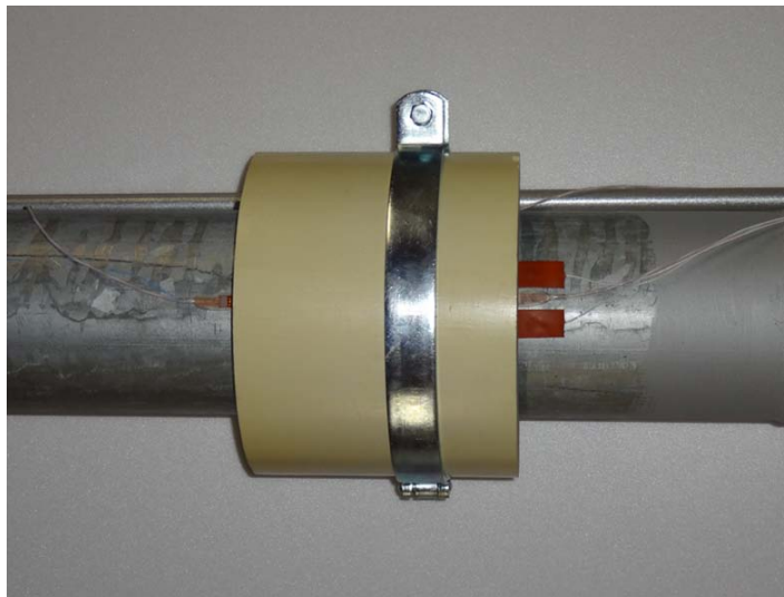
写真 流量計測用センサ設置状況
